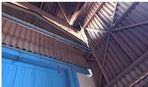
Figura 25 – Ponto de vazamento de ar
