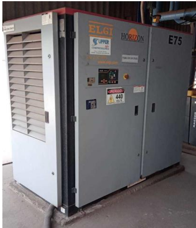
Figura 20 – Compressor ELGI (2 unidades)
