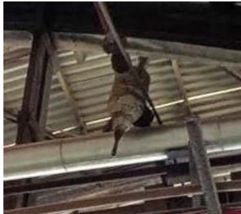
Figura 24 – Acessórios da linha necessitando de manutenção
