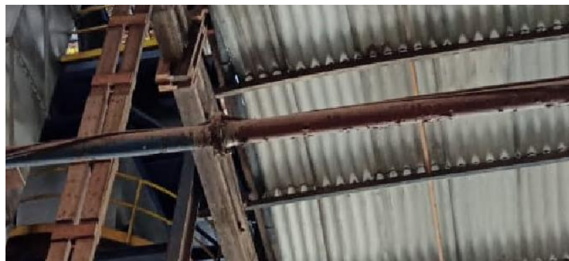
Figura 22 – Tubulação com pontos de corrosão
